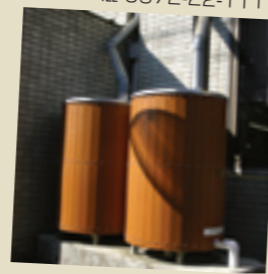
多治見市役所の雨水貯留タンク
