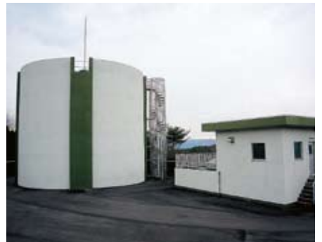
たかたはいすいち 高田配水池 こけいざんじゆすいち おく みず 虎溪山受水池から送られてくる水をつ ため、高田、東山方面の家庭に給水し ます。
