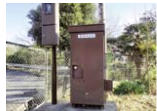
マンホールポンプ
