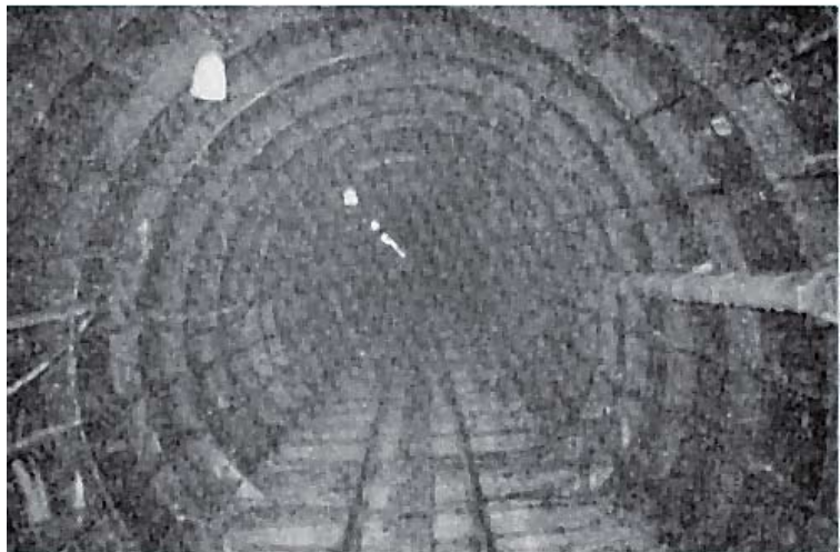
下水道工事 (上)昭和50年豊岡町の工事 (下)前畑町から処理場まではシールド工法がとられた。
