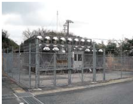
きたおぎはいすいち 北小木配水池 あさひがおかはいすいち おく みず 旭ヶ丘配水池から送られてくる水をた めて、北小木地区の家庭に給水しま す。
