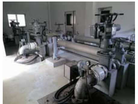
いちのくらすうすい じよう 市之倉送水ポンプ場 たきろじゆすいち おく みず いちのくら 滝呂受水池からの水をポンプで市之倉 配水池に送ります。
