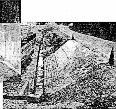
▲豪雨による側面崩れ
