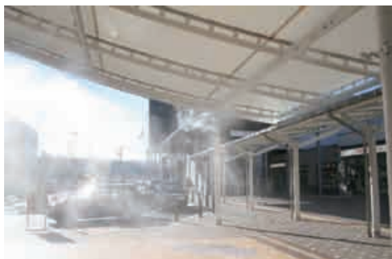
駅南ミスト設置状況
