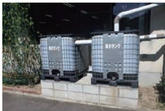
消防本部の雨水貯留タンク
