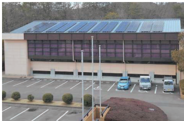
総合体育館の太陽光発電設備
