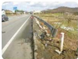
ガードレール・ 標識等の損傷
