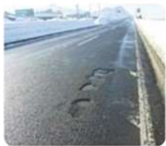
路面の穴ぼこ・ 段差
