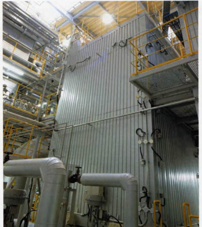
■ ろ過式集じん器 バグフィルタの採用により排ガスをクリーンにします。
