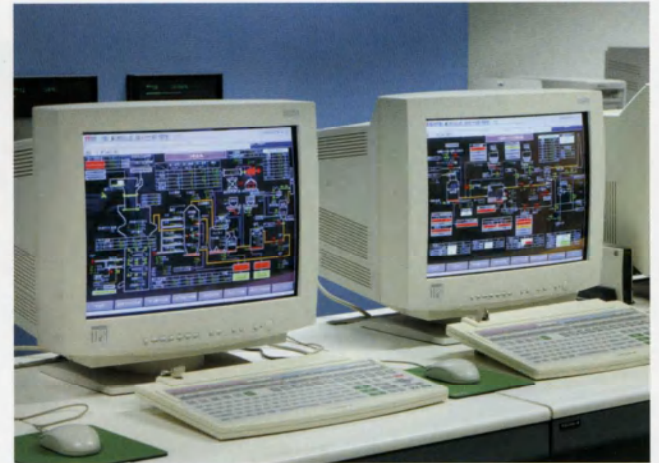
■モニター画面 各設備の稼動状況や、排出される排ガスのデータは常時 モニター画面に表示されます。
