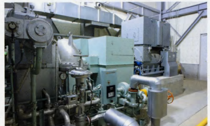
■ 蒸気タービン・発電機 廃熱ボイラから発生する蒸気を利用して発電し、施設内の電力を賄います。
