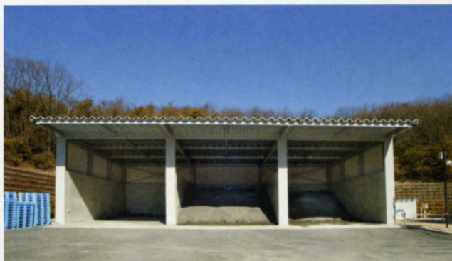
■ストックヤード スラグの貯留を目的とした、側壁・屋根を備えたヤードです。
