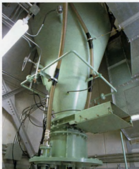
■活性炭貯留槽 排ガス中に活性炭を吹き込むことにより、ダイオキシン類をその微細な穴の中に吸着させて回収します。
