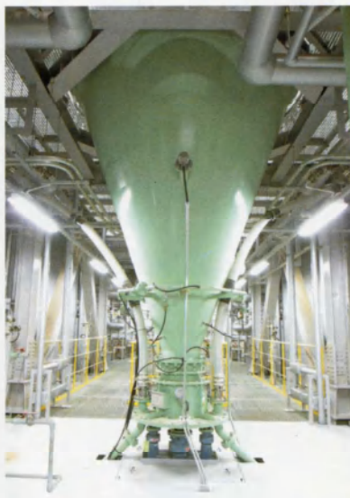
■塩化水素除去装置 バグフィルタの前段に位置し、乾式法により排ガス中の有害物質である塩化水素(硫酸化物を含む)を除去します。
