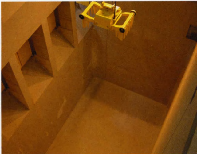
■ごみピット・ごみクレーン ごみは一旦貯留され、ごみクレーンによりピット内で 攪拌処理などを行った後、熔融炉に投入されます。
