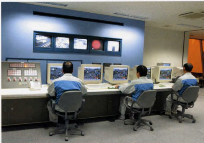
■中央制御室 本施設の頭脳ともいべき場所で各設備のデータをコンピュータにて 集約・管理しています。
