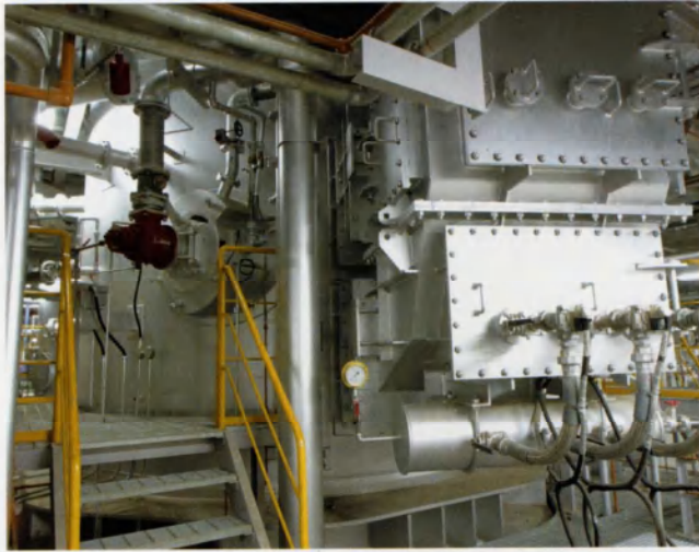
■ 燃焼室 溶融炉より発生した熱分解ガスを完全燃焼する独立した燃焼室です。
