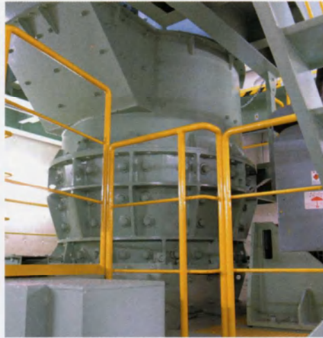
■高速回転式破碎機 高速で回転するハンマーにより、ごみを選別しやすい様細かく砕きます。
