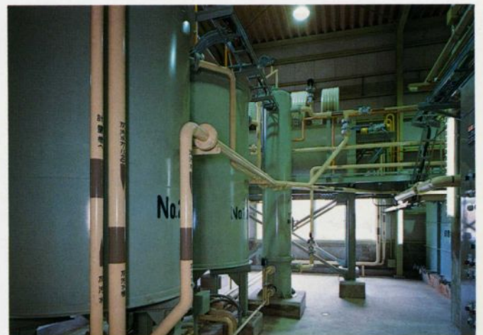
排水処理設備
