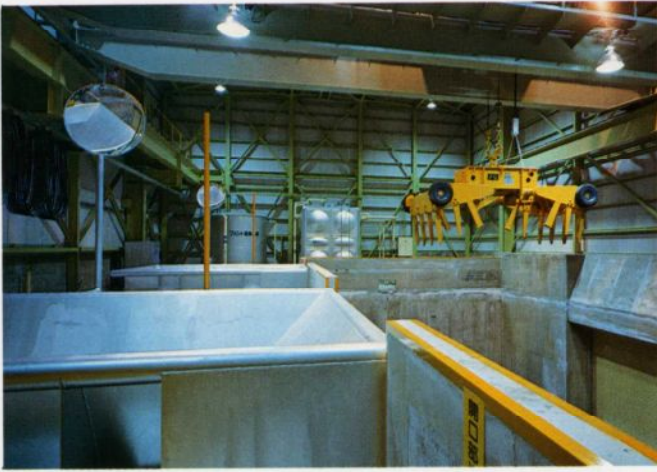
ゴミクレーン
