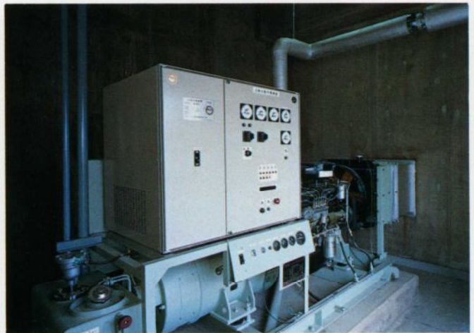
非 常 用 発 電 装 置
