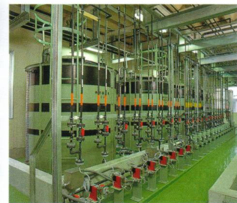
●薬品注入設備
