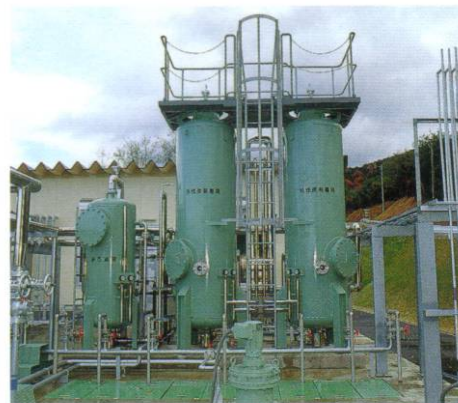
●砂ろ過塔・活性炭吸着塔
