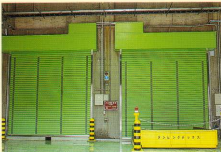
■プラットフォーム 計量されたごみを、ごみピットに投入します。持ち込み車はダンピングボックスを使用します。
