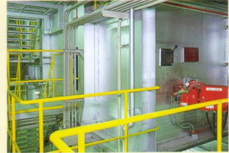
■焼却炉 ごみは炉内でストーカによって解きほぐされながら、完全燃焼します。
