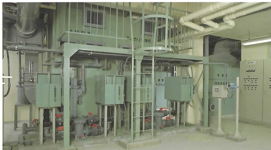
●高濃度臭気脱臭設備 受入・貯留槽や前処理機械などで発生する高濃度臭気は、曝気プロフに導き、曝気槽で生物脱臭処理します。
