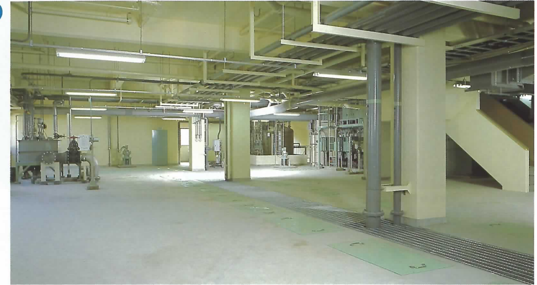
●1次・2次処理室 前処理分離液を、希釈水・返送汚泥などとともに混合・曝気し、微生物によって有機物と窒素化合物の分解・除去を行います。
