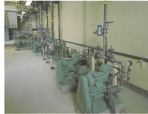
●地下ポンプ室 受入れたし尿や浄化槽汚泥に含まれている紙や布・ビニールなどを破砕機で細かく切断します。また、前処理分離液を定量的にポンプで圧送します。
