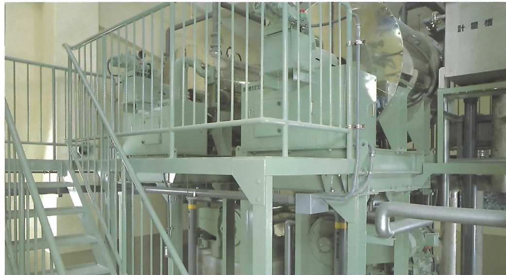
●前処理設備 し尿に混じっている布・紙・ビニールなどは破砕機で細かく切断し、細目スクリーンとスクロープレスで分離・脱水します。
