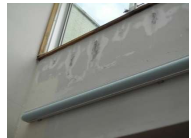
3-2 壁の塗装の剥れ
