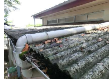
5-3 雨樋 落ち葉等の詰り
