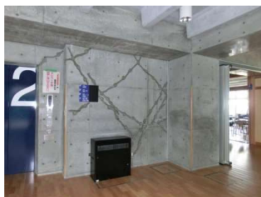
2-1 RC躯体損傷
