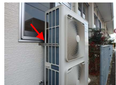
1-6 空調設備室外機の転倒防止策
