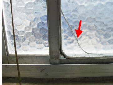
2-2 ガラス固定材ビードの外れ
