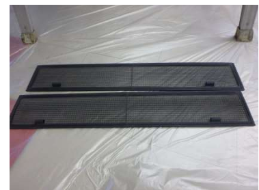
1-3 空調設備フィルターの清掃
