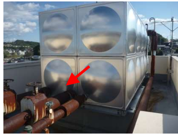
1-8 受水槽配管類の劣化、錆
