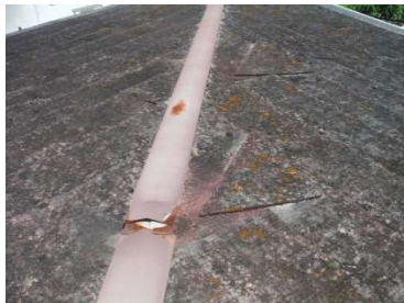
2-4 カラーベスト葺材のスレ、塗装劣化等
