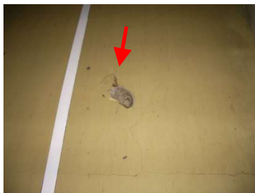
2-4 床長尺シートの劣化
