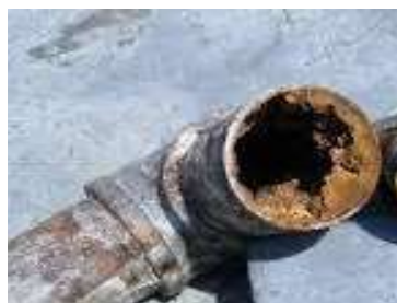
1-2 水道管内の錆
