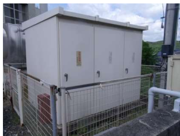
2-1 受変電設備、フェンス
