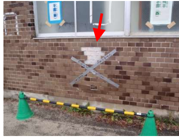
1-2 外壁タイルの落下、浮き
