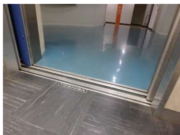
1-1 エレベータ： 籠と床面との段差
