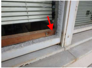
2-1 ガラス固定材パテの劣化、硬化
