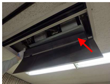
1-2 空調設備フィルターの清掃
