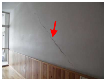
3-1 壁のひび割れ
