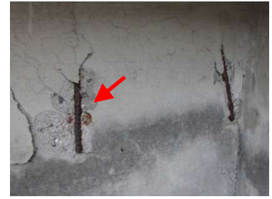
1-3 モルタル剥落、内部鉄筋露出
