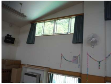
1-1 排煙窓の動作不良
