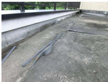
3-6 押えモルタル目地材の劣化
