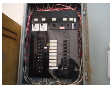
1-2 漏電遮断器 (分電盤内部)
