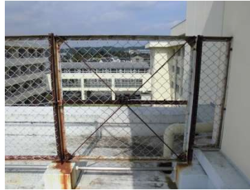
6-1 屋上フェンスの錆 (基礎コンクリートの破損)
