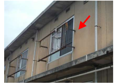
1-3 窓鉄格子の錆
