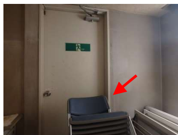
6-1 避難経路の障害物
