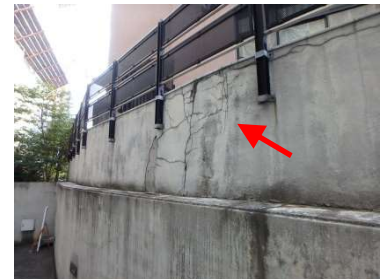
3-4 フェンス基礎部の破損 擁壁のひび割れ
