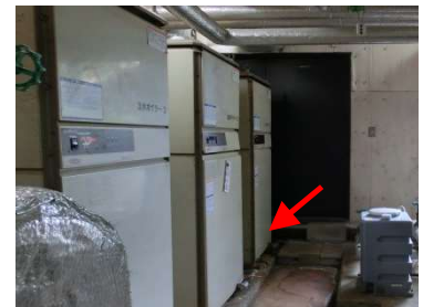
7-1 ボイラーの錆
