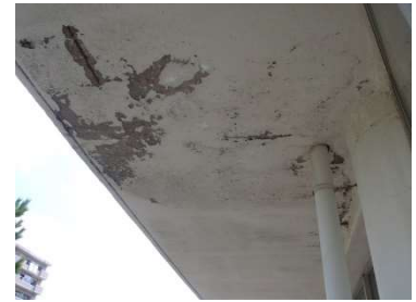
1-6 鉄筋露出、モルタル浮き塗装材剥離、
