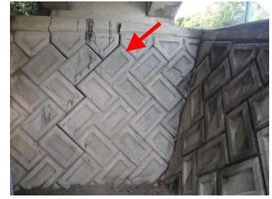
5-1 ブロック擁壁のひび割れ
