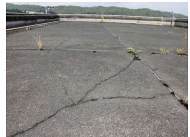
3-5 押えモルタルのひび割れ 目地部分の雑草繁殖
