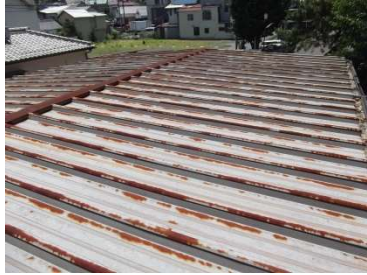
2-1 鋼板屋根の錆
