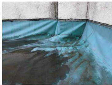
3-1 防水シートの浮き
