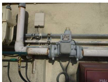
1-2 ガス管の塗装剥れ、錆
