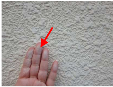
1-5 外壁塗装チョーキング現象
