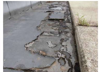
3-2 塗膜防水層の剥れ、破れ
