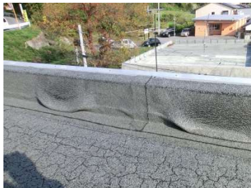
3-3 アスファルトシート防水の膨れ、ひび割れ
