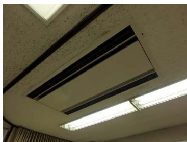
1-1 空調設備（室内機）の劣化（錆、異音、液漏れ等）
