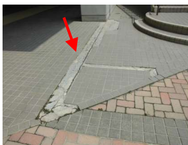
2-1 舗装タイルの剥れ
