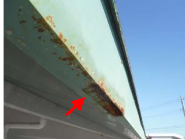
2-2 鋼板屋根（軒先）の錆
