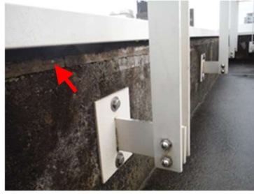
近影: 不具合(異常、故障等)の状況がわかるように撮影
