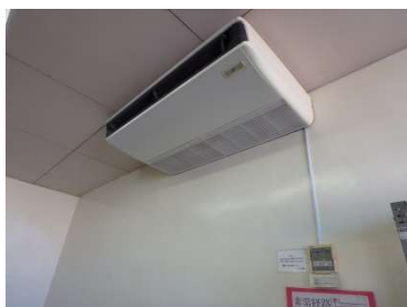
1-4 空調設備（室内機）の劣化（錆、異音、液漏れ等）
