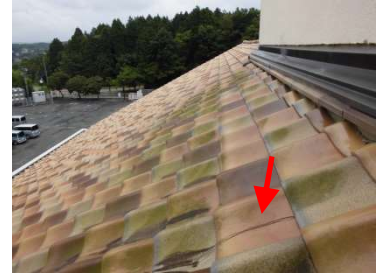
2-3 瓦屋根のひび割れ
