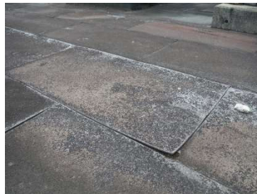
3-4 仕上材（砂入塗料）の剥離
