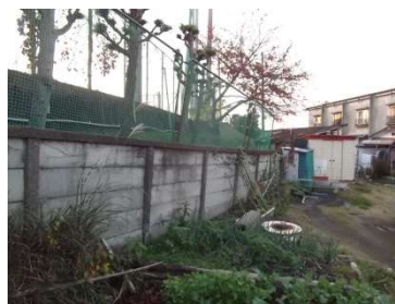
3-3 塀の劣化、傾き
