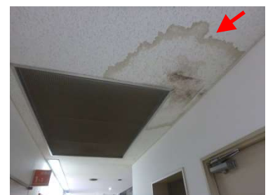
4-1 天井板の雨漏りあと (雨漏りによる変色)
