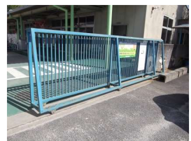
3-1 門扉 塗装剥れ、錆
