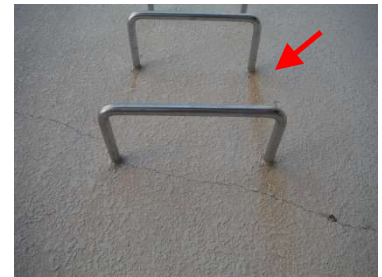
3-4 外壁タラップ根元からの錆汁
