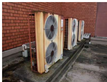
1-5 空調設備（室外機）の錆（錆、異音、液漏れ等）
