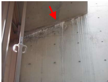
2-1 外壁からの雨水侵入あと
