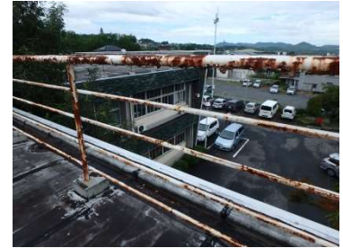
6-2 屋上手すりの錆
