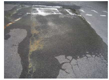
1-6 地面の濡れ → 配管漏水可能性有
