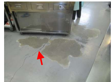
2-3 床のひび割れ、塗装剥れ
