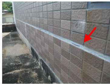
3-1 タイル目地シーリングの亀裂
