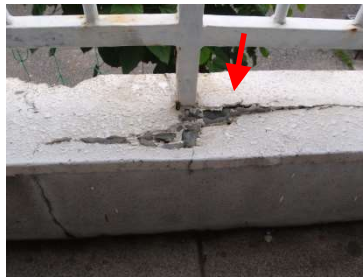
3-3 手すり根元コンクリートの欠損
