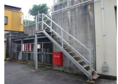
3-1 外部鉄骨階段の錆
