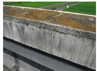
4-2 笠木のひび割れ
