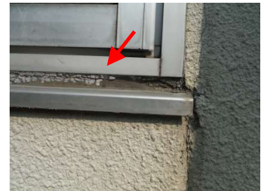
3-2 建具廻りシーリングの劣化
