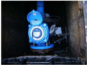
1-7 水道メーター： 漏水（涙）マークの点滅
