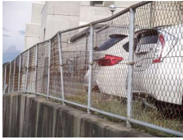
3-5 フェンス傾き
