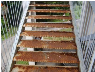
3-2 外部鉄骨階段の錆
