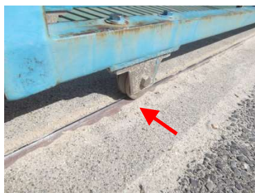
3-2 門扉の開閉不良 (レールの砂等)
