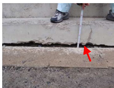
2-2 陥没による隙間
