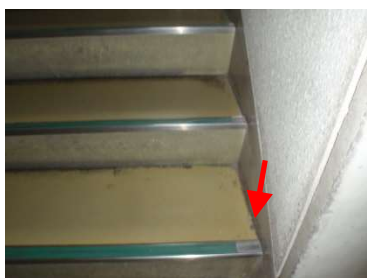
6-1 階段 段鼻 ノンスリップ材の劣化
