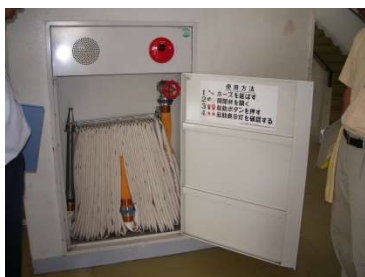
3-2 消火設備 (屋内消火栓)
