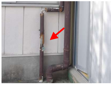
1-4 配管保温材の劣化
