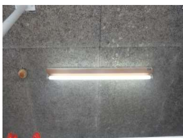
1-1 照明器具の劣化 (錆、異音、液漏れ等)
