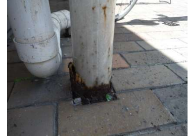
7-2 鉄柱根元の錆
