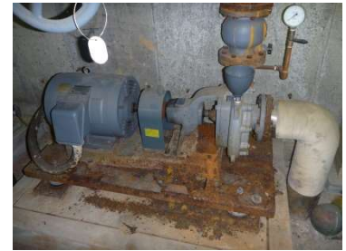
1-9 ポンプの劣化 (錆、異音、異臭、漏水等)
