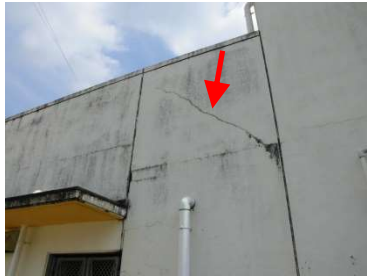
1-1 外壁のひび割れ
