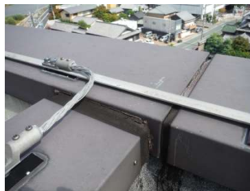
4-1 笠木シーリング劣化（ひび割れ、硬化等）
