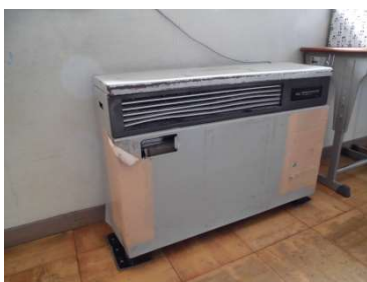
2-1 暖房機器の劣化
