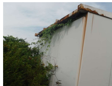
2-2 受変電設備 錆、 植物侵入
