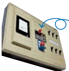
感震ブレーカーを分電盤に設置した実例。大きな地震の揺れにより赤い玉が落下することでブレーカーを自動的に遮断する。
