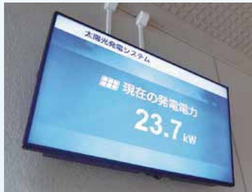
ロビーに設置されたモニター
