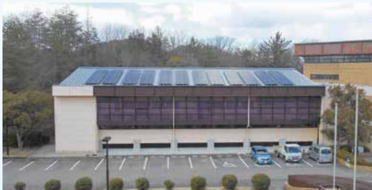
第2体育館屋根に設置された太陽光発電設備
