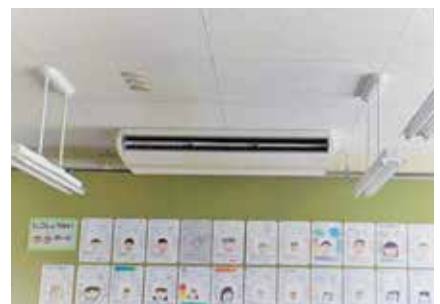
共栄小学校に設置されたエアコン
