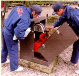
▲ 放水銃の点検 (消防本部)
