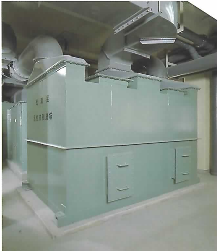
●中濃度臭気脱臭設備 攪拌槽・曝気槽などからの中濃度臭気は、薬品洗浄による湿式脱臭処理ののち、活性炭脱臭処理を行います。
