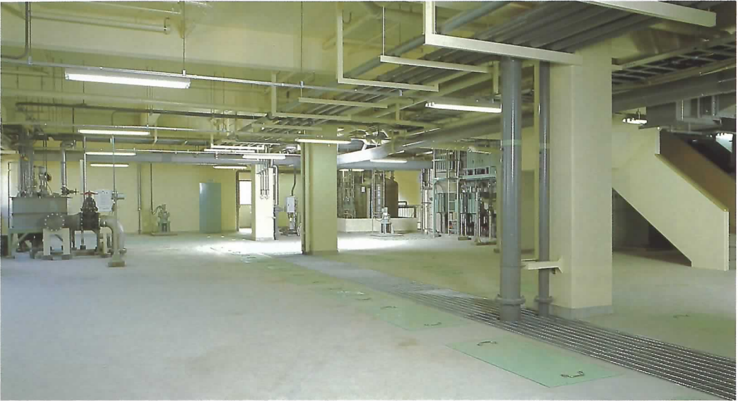
●1次・2次処理室 前処理分離液を、希釈水・返送汚泥などと混合・曝気し、微生物によって有機物と窒素化合物の分解・除去を行います。
