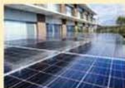
4F 太陽光パネル
