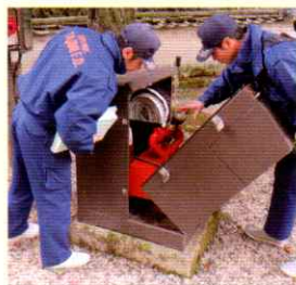
▲放水銃の点検（消防本部）
