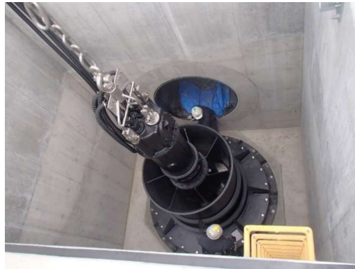
② 土岐川右岸ポンプ
