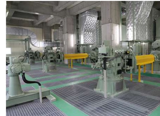
③ 土岐川左岸ポンプ
