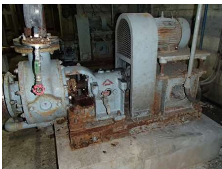
② ポンプ設備の劣化(池田)
