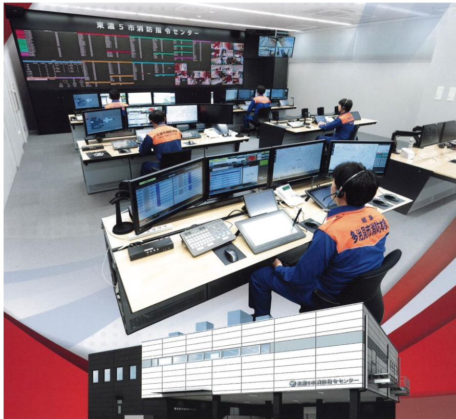
東濃5市消防指令センター(令和8年4月運用開始)
