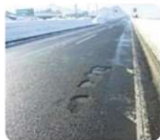
路面の穴ぼこ・ 段差
