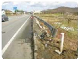
ガードレール・ 標識等の損傷
