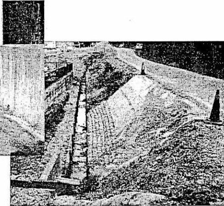
▲豪雨による側面崩れ
