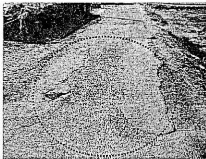
▲市道の舗装劣化
