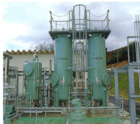
●砂ろ過塔・活性炭吸着塔
