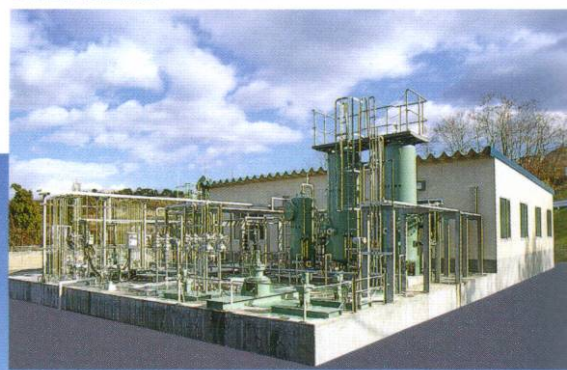
●漫出水処理施設
