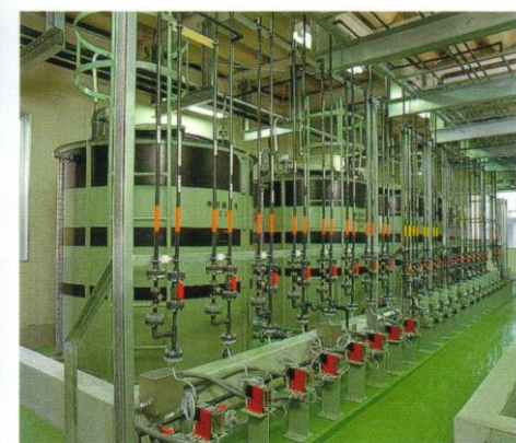
●薬品注入設備
