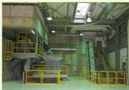
■粗大ごみプラットホーム
