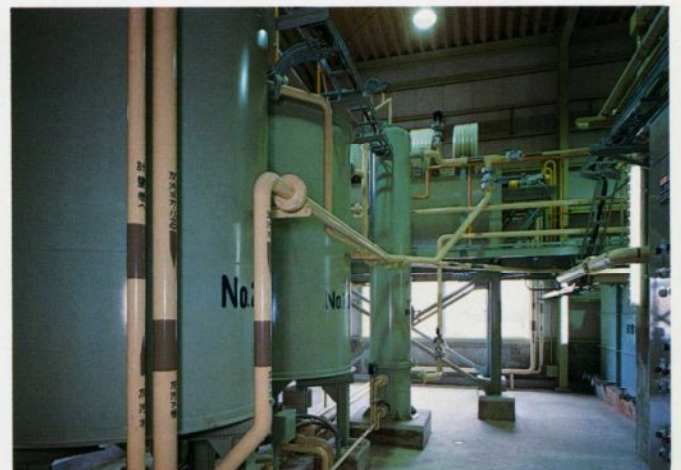
排水処理設備
