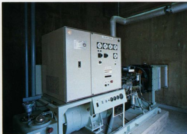
非 常 用 発 電 装 置
