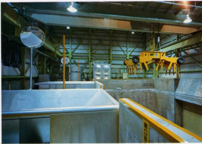
ゴミクレーン
