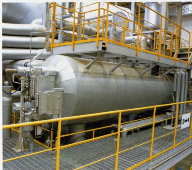
■ 廃熱ボイラ 燃焼室から送られた排ガスを利用して蒸気を作ります。 また、燃焼排ガスを200℃以下まで冷却します。
