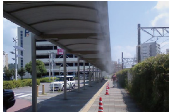
図 2-5-6 : 駅北ミスト設置状況 (写真)
