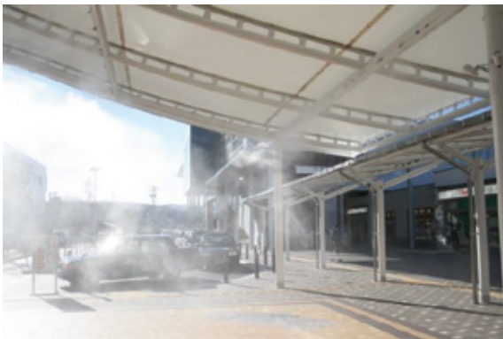
図 2-5-5 : 駅南ミスト設置状況 (写真)
